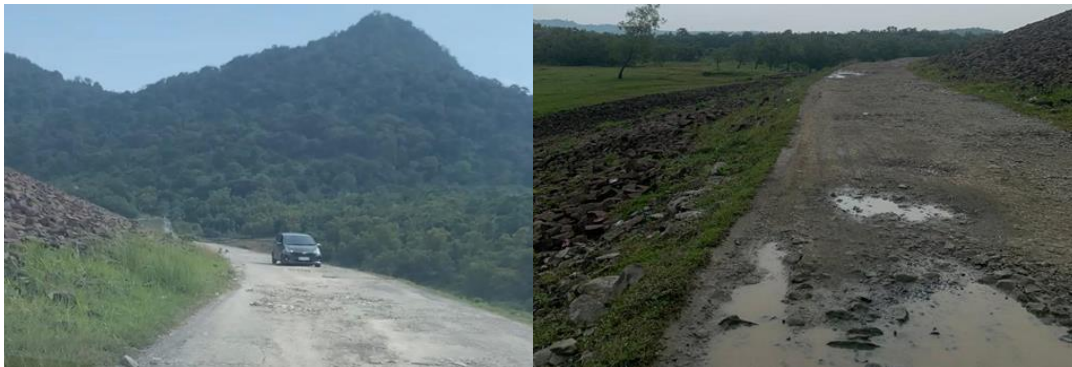
Gambar 1. Kondisi Jalan di Waduk Jatiluhur (sumber: Data Survey, 2023)
